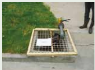
好氧池管道整理
