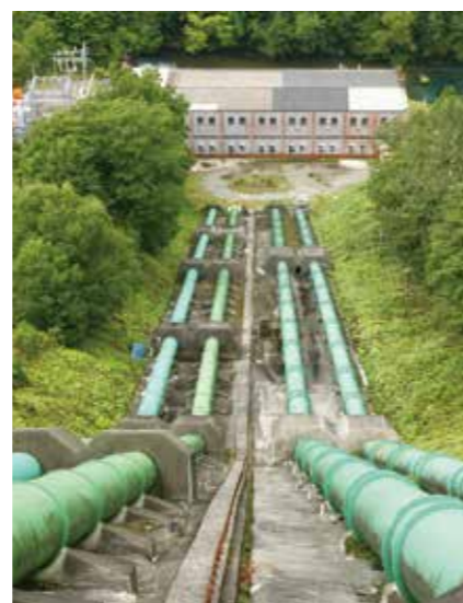
千叶第一水力发电所
